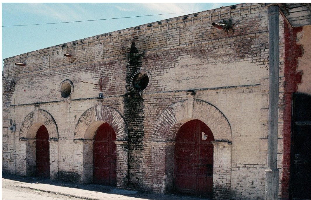
Entrepôt à gargouilles saillantes (HAJAC0033). On distingue le dépôt noir de moisissures ou de champignons sur le mur à l'aplomb de la gargouille manquante.
