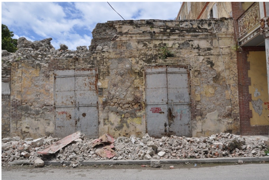
Entrepôt (HAJAC0045) fort endommagé en 2010. On distingue la maçonnerie de moellon et de brique enduite, l'encadrement des baies et les chaînages d'angle en brique.
