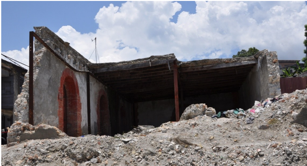
Un des entrepôts Vital (HAJAC0017) éventré par le séisme. On distingue les poteaux et poutres métalliques portant les solives en bois qui soutiennent le toit terrasse en mortier.
